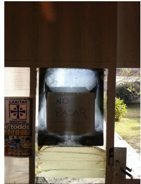
Fenêtre réparée à l'aide d'une radiographie et indiquant : "No passar"
