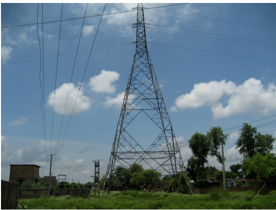
L'alimentation en électricité des pompes en question
